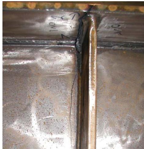
Bild 8: Ermüdungsversagen im Bereich der Quersteife
