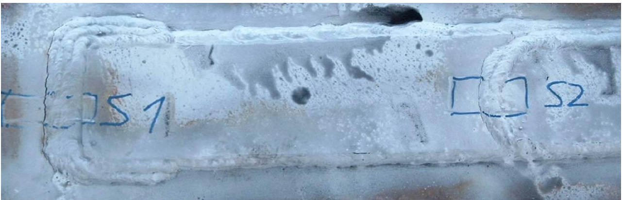
Bild 23: Anrisse an Quernähten der aufgeschweißten Verstärkungsblechen
