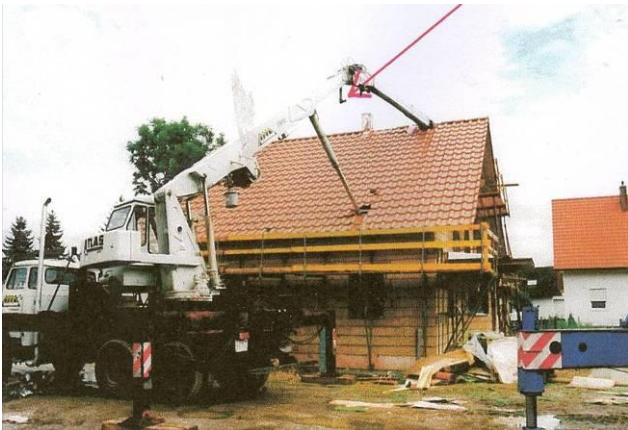
Bild 34: auf Hausdach gestürzter Ausleger
