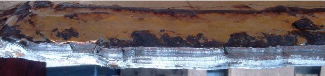
Bild 26: Typischer Dauerbruch im Auslauf der Quer-Schweißnaht
