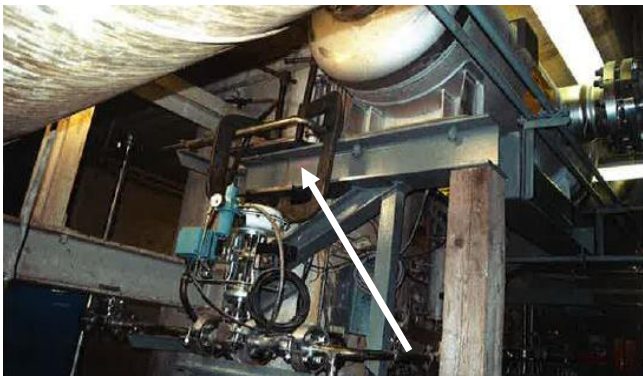
Bild 21: durch Schwingungen gerissener Träger
