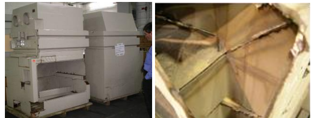
Bild 12: Kühlergehäuse Bild 13: Innenansicht
