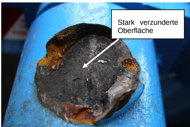
Bild 20: Schweißnaht am Zylinderauge
