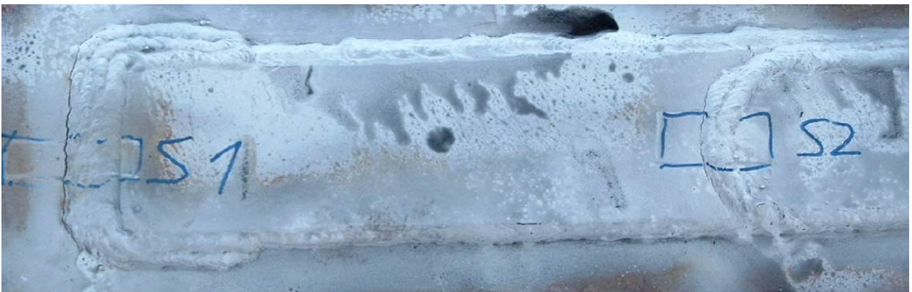
Bild 23: Anrisse an Quernähten der aufgeschweißten Verstärkungslaschen
