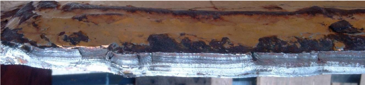
Bild 26: Typischer Dauerbruch im Auslauf der Quer-Schweißnaht
