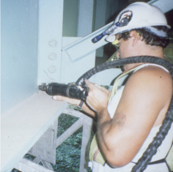
Bild 14: UIT-Behandlung an Brückendetail
