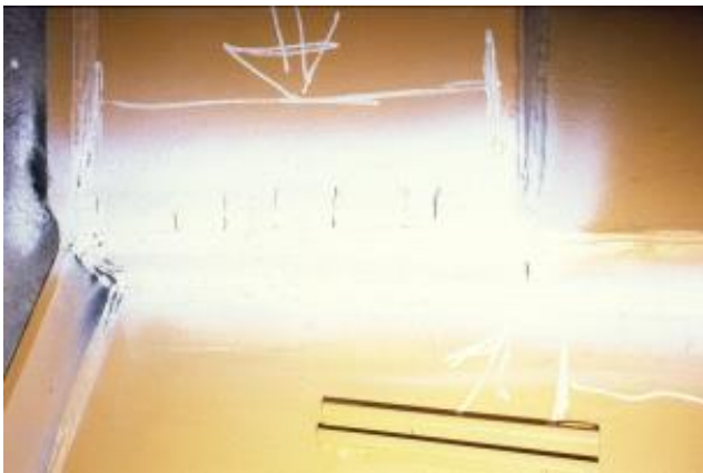
Bild 5. Kaltrisse in der Schweißnaht
